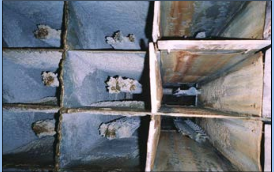
PLACAS SUCIAS (LIMPIEZA INTERMITENTE DURANTE LA OPERACIÓN)
